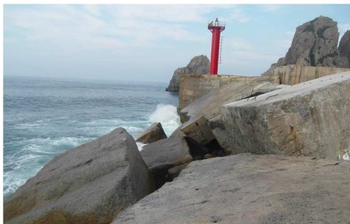
(a) 가거도항 방파제 피해 사례
