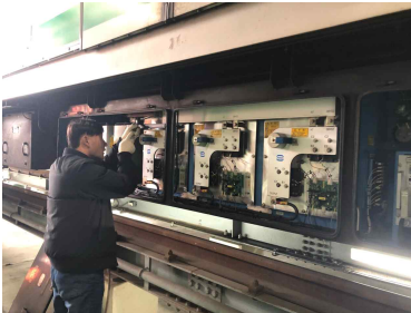
(d) 시작품 실차 설치
