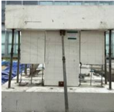
(a) 콘크리트 및 좌굴된 철근 제거
