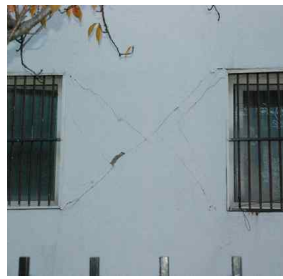
(b) 조적채움벽 전단균열 및 미장 탈락
