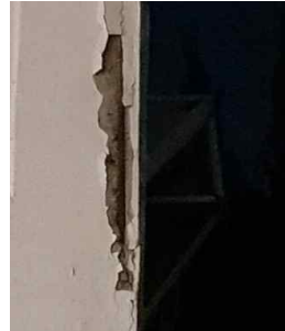
(A) 피복탈락에 의한 철근 노출
