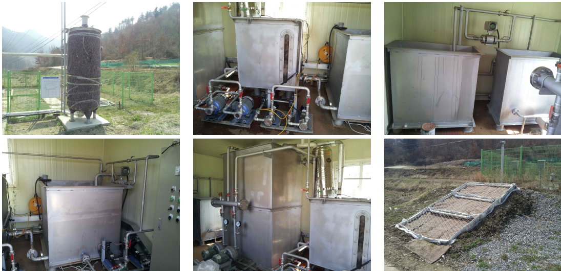
[그림 3-3] 시운전 중인 pilot plant 현장
