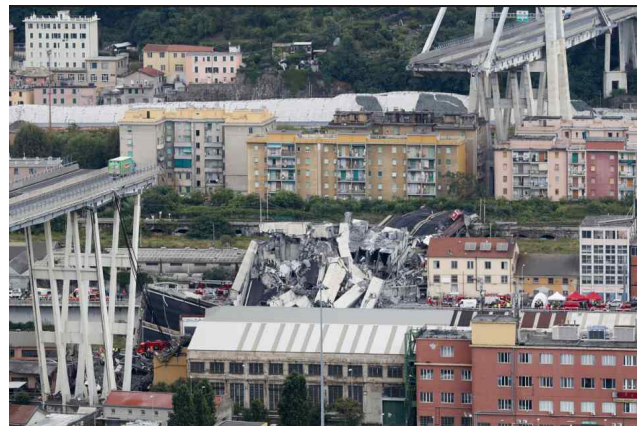
모란디 교량 붕괴(2018, 이탈리아 제노바)
