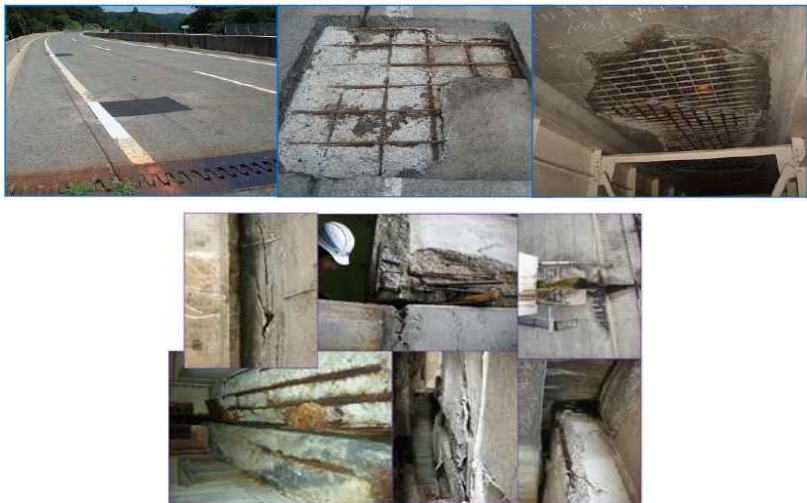
<그림 1. 제설염해 염분에 의한 도로구조물 교각 상부 및 하부/측부의 철근부식>
