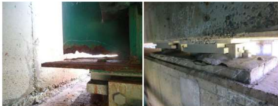
<그림 15. 서일본 고도고속도로 교각 하부의 콘크리트 구조물 및 철근의 부식으로 인해 염해 심각 확인>
