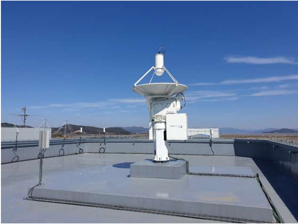
옥상 설치 전경(추적 안테나)
