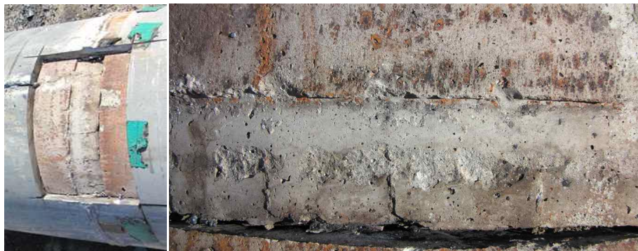
그림 159. 충전강관 용접부 후면 콘크리트 열화 사례
