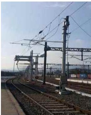
부하개폐기 설치 전경
