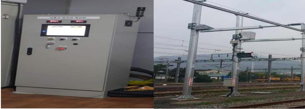
그림 50. MAIN 제어반 및 LOCAL 반
