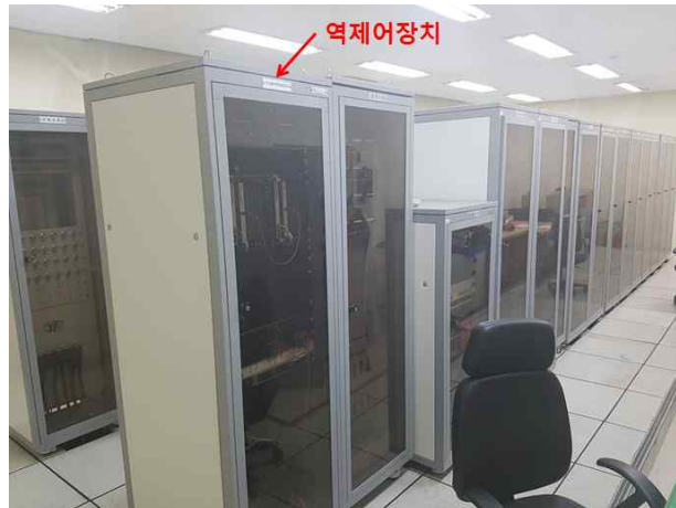
[그림 3-44] 정읍역 역제어장치 설치
