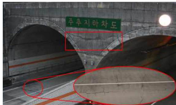
그림 1.3 세종특별자치시 주추지하차도 - 혹한기 겨울공사 강행으로 인한 균열 (금강일보, 2017. 04. 26)
