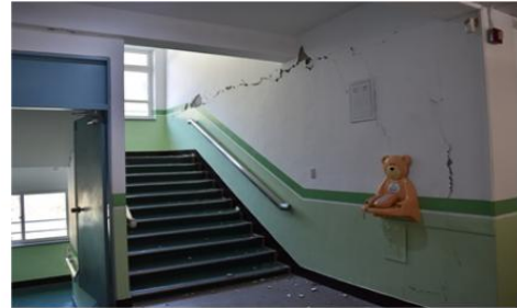
비내력 조적벽 균열
