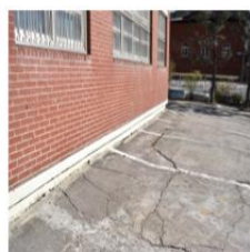
주차장 바닥 균열
