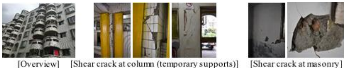
<그림 2.24> 2번 건축물 지진피해 조사 사진
