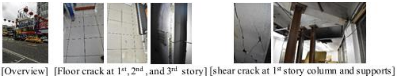
<그림 2.27> 5번 건축물 지진피해 조사 사진
