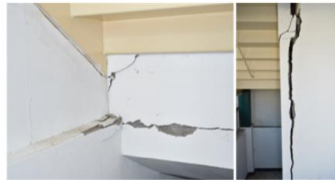
비내력 조적벽, 계단 균열 및 손상
