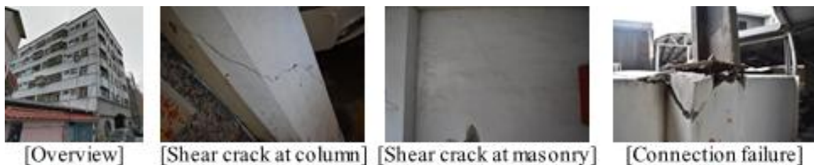
<그림 2.23> 1번 건축물 지진피해 조사 사진
