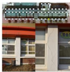
기둥 전단 균열
