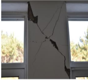
기둥 전단 균열
