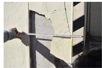
기둥 콘크리트 탈락
