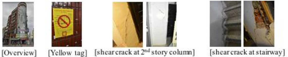
<그림 2.26> 4번 건축물 지진피해 조사 사진
