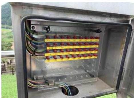
제체 설치된 전기비저항 탐사 배전판
