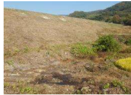
하류사면 끝단부 연약화 상태
