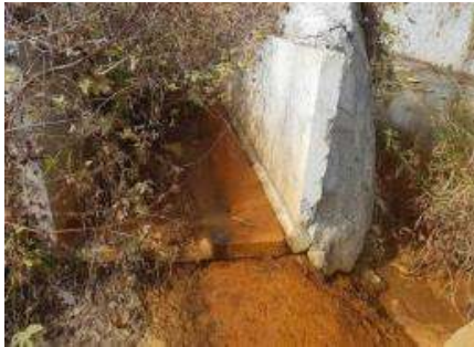
여수로 균열 및 이탈 상태
