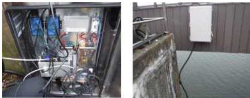
그림 81. 어우교 레이더유속계, 압력식 유속계 시스템 설치
