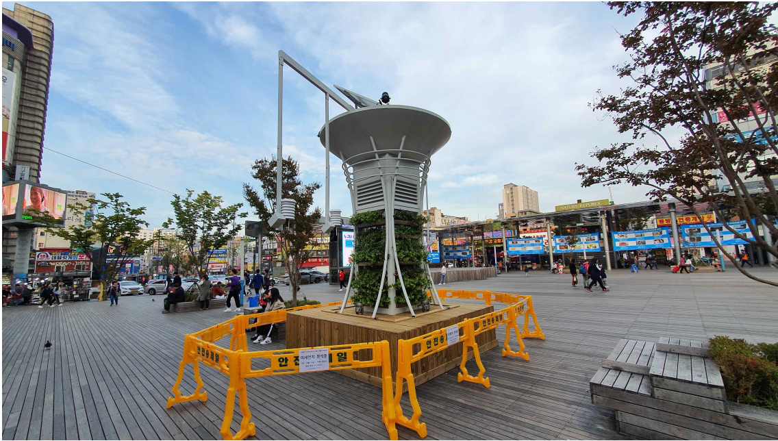
[그림 2-102] 미세먼지 저감효과 모니터링을 위한 실외공기측정기 설치현황 (저감장치 내)
