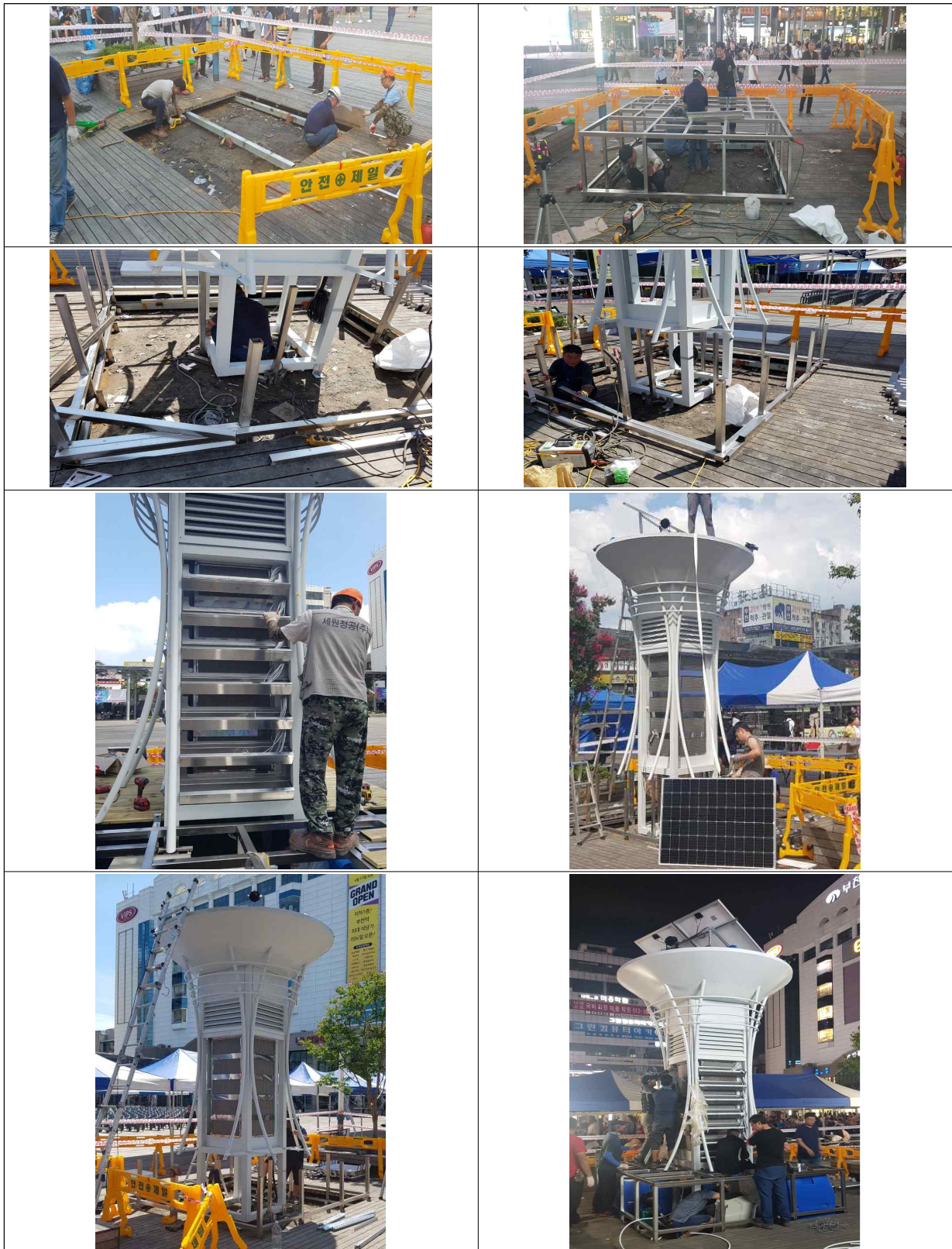
[그림 2-35] 미세먼지 저감장치의 설치 과정
