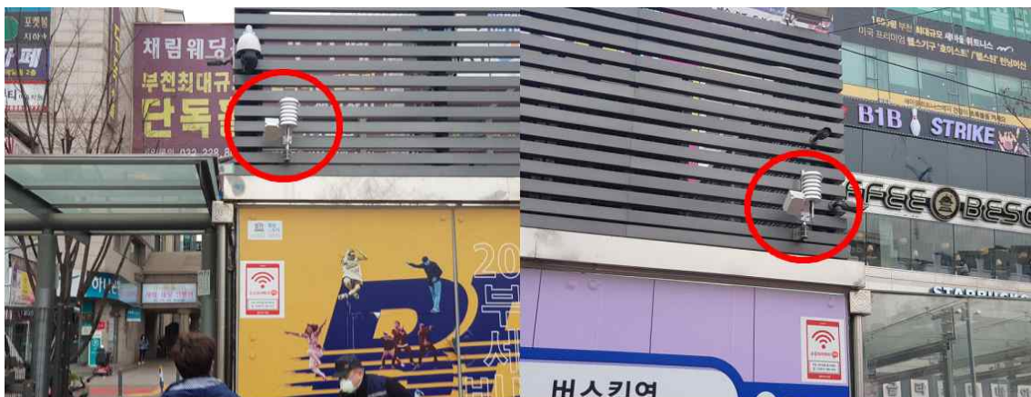
[그림 2-101] 실외 미세먼지 농도 모니터링 측정기 설치 현황(미세먼지 처리범위 외 지점)
