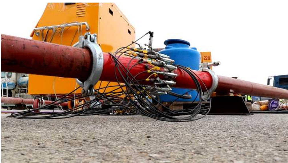
[그림 2.9] 유회층 활성화제 주입장치의 주입부 설치 전경
