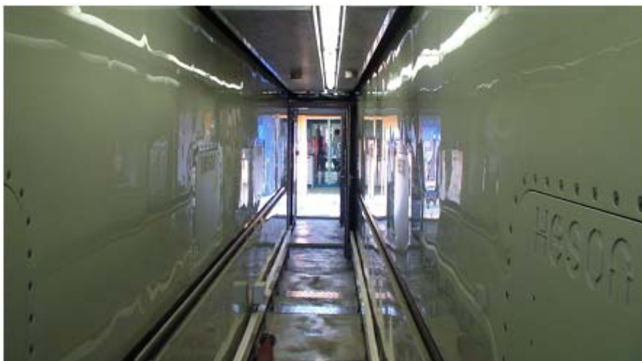
그림 30. 철도차량 내부 좌우에 설치된 물탱크
