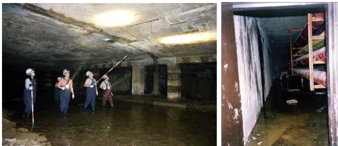
〈그림 1-6〉 36년 된 복개지하구조물의 균열상태(부산) 〈그림 1-5〉 지하공동구 손상
