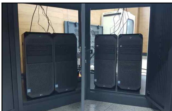
종합관제실 콘솔 설치
