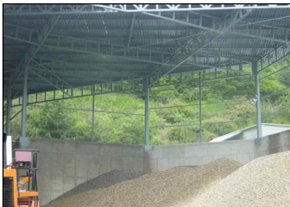
[그림 2-11-2] 야적장 내 프리웨팅 설비
