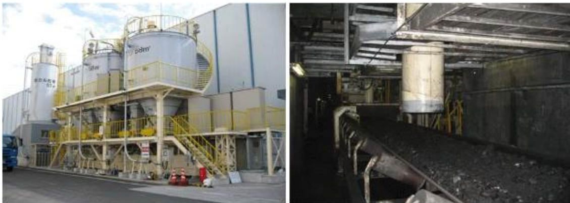
[그림 2-7] 일본 나코노 발전소 슬러지 탄화연료 저장 및 공급 시설
