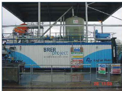
(d) 슬러지 건조/가스화/발전 설비 전경
