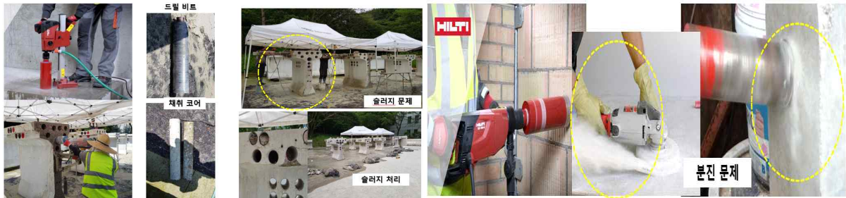
[기존 습식 코어 및 건식 코어 천공 기술 문제점]
