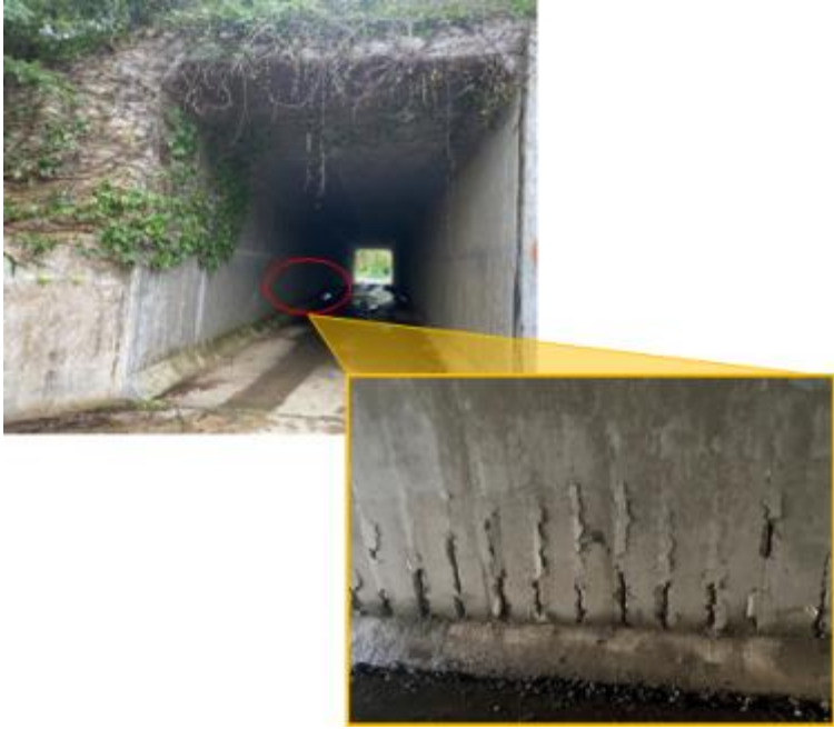
그림 36 손상된 콘크리트 터널 현장
