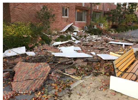
(b) 공동주택 외벽 파손
