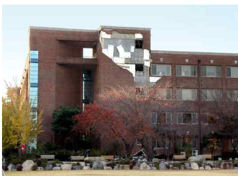
(a) 학교 외벽 파손
