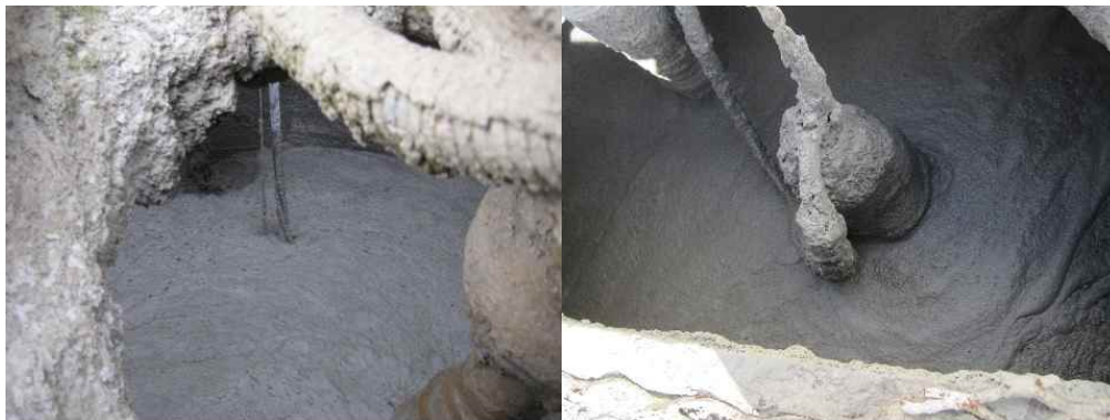
a) 탱크 내부에 설치된 수중 펌프 b) 고착된 상태의 수중 펌프
