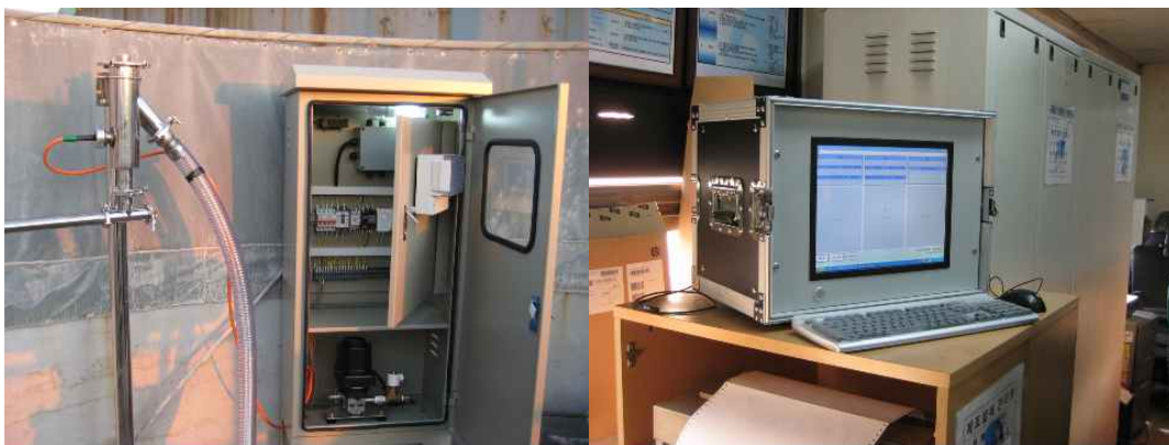
a) 농도 측정 장치 및 Controller b) 현장 사무실 내부 설치 Panel
