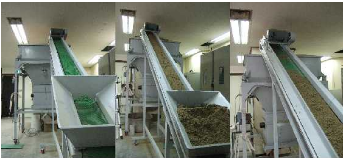
그림 3.4.25 실제 레미콘 잔골재 이송과정을 묘사한 컨베이어벨트
