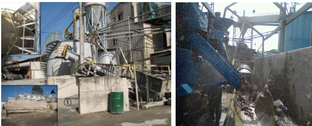
그림 3.1.1 레미콘 공장의 회수수 처리 시설
