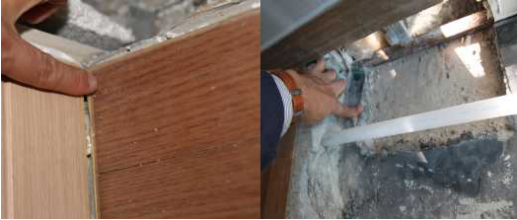
[그림 1.2.5] 내구성능이 열악한 바닥완충재를 사용한 공동주택의 바닥 마감재 침하(2012년 A아파트)
