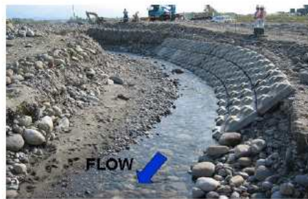
(b) 護岸付近の深掘れ
