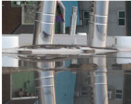
실란트 부위 파손
