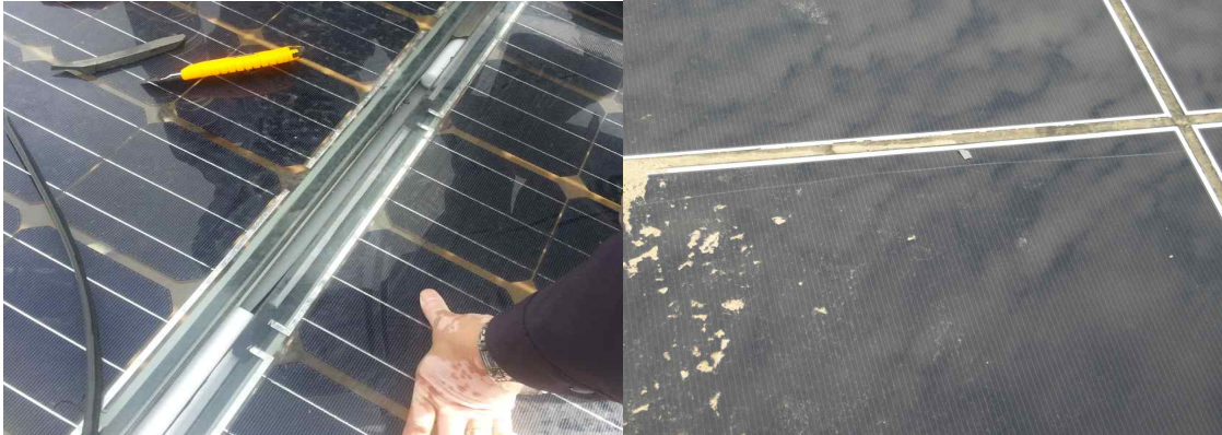
백업제 부재로 인한 코킹 터짐 현상
