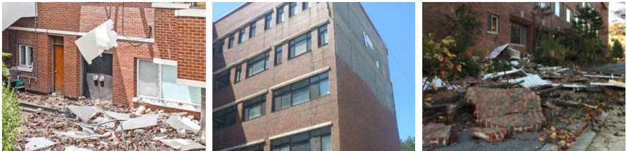
[그림 1.1] 지진 및 노후화로 인한 치장벽돌 탈락 사고 모습
