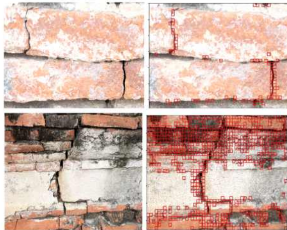
[그림 1.8] 조적 구조물에 대한 균열 탐지 예시
