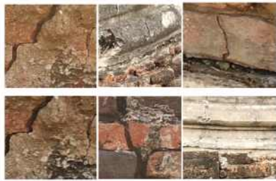
(a) 조적조 균열 이미지
