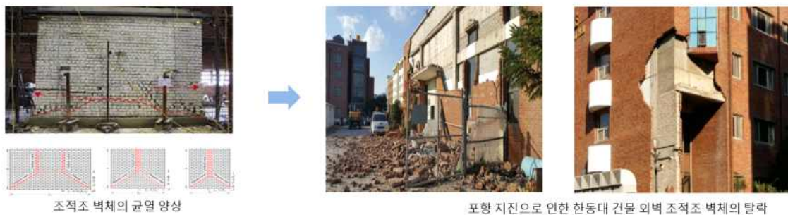
[그림 1.3] 조적조 벽체의 균열 양상 및 피해 현황
