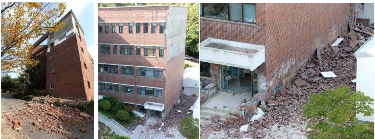
[그림 1.2] 지진에 의한 한동대 외벽 탈락 및 노후화로 인한 부산대 외벽 탈락 사고 모습
