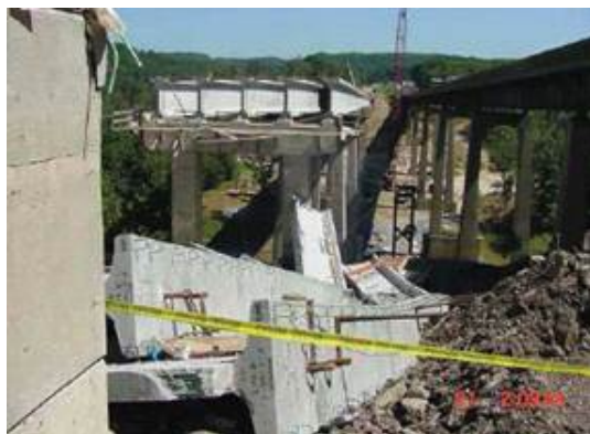
그림 3.2.1. Stability Failure of 2.3m deep precast prestressed concrete girders in Pennsylvania
