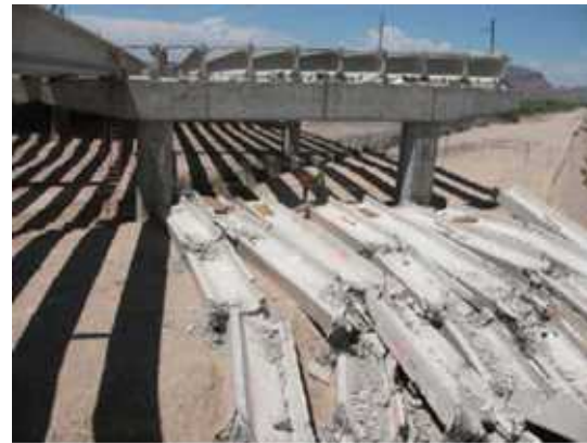
그림 3.2.2. Stability failure of AASHTO Type V bridge girders in Arizona
