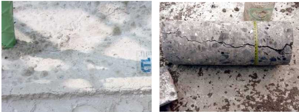
[그림 1.2] 매스콘크리트의 온도균열 발생 예
