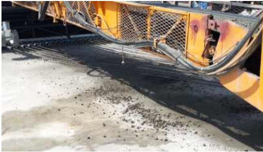
<그림 3.90> 바닥부 콘크리트 낙하
