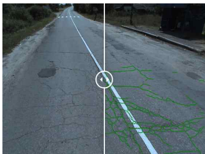
그림 13 딥러닝 기법을 이용한 균열 탐지
