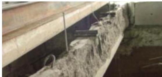
그림 12 고강도 콘크리트 보의 폭열현상
