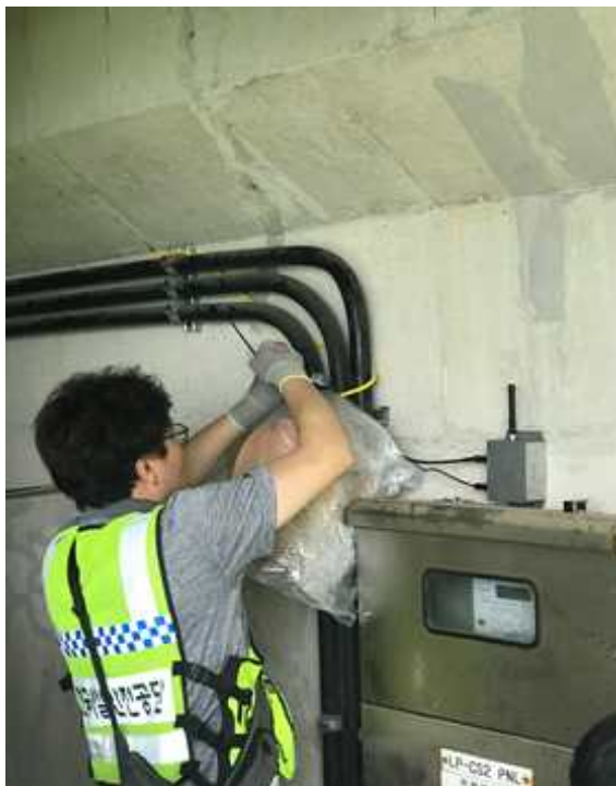
<그림 3.64>RTD 온도센서 설치
