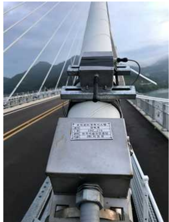
(d) 설치된 케이블 장력계
