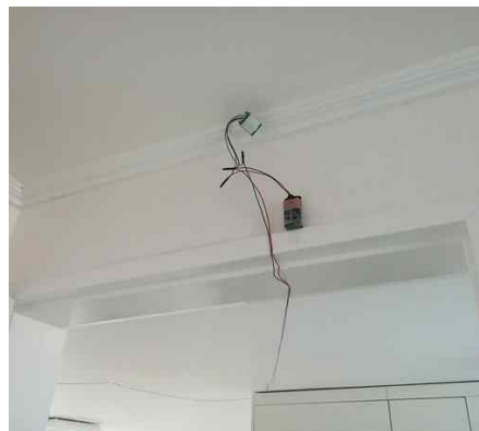
(b) PIR 센서 설치 (침실)
