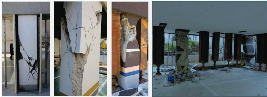
[그림 2.90] 포항 장성동 필로티 구조물의 기둥 전단 파괴 사례 예시
