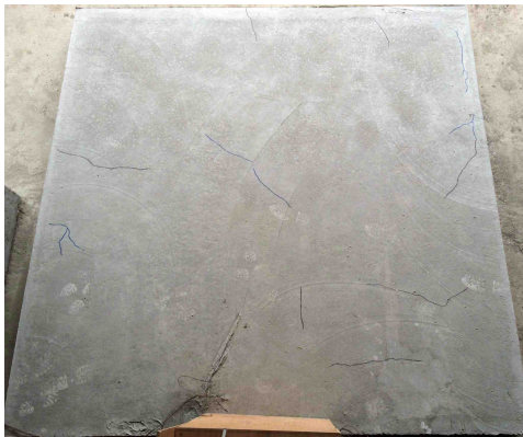
(a) 균열 측정 사진
