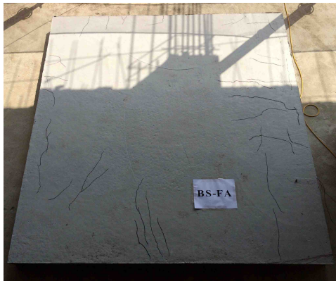
(a) 균열 측정 사진
