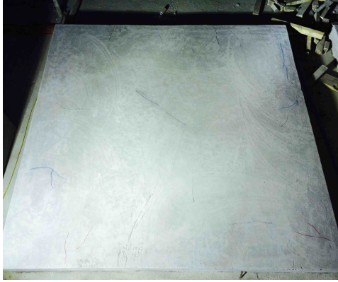
(a) 균열 측정 사진
