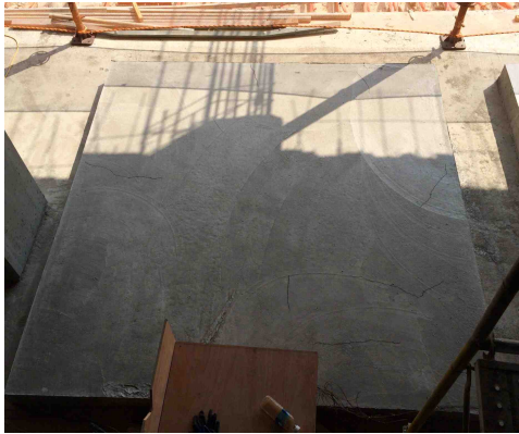
(a) 균열 측정 사진
