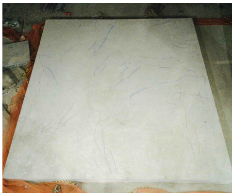
(a) 균열 측정 사진
