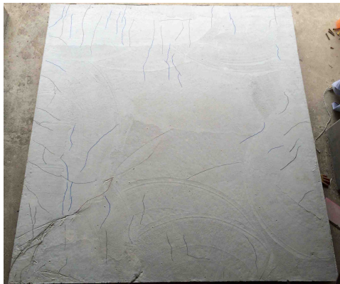
(a) 균열 측정 사진
