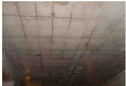
건조수축에 의한 소성균열
