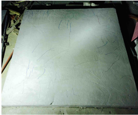
(a) 균열 측정 사진
