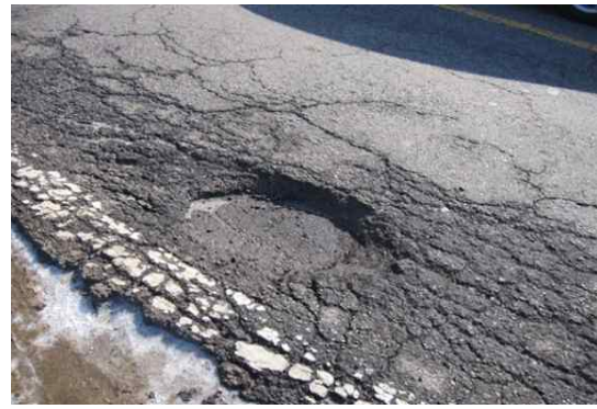
그림 1.3 제설제로 인해 발생한 도로 파손
