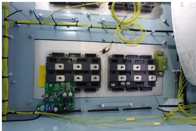
인버터 유지보수 편리성을 적용한 사진
