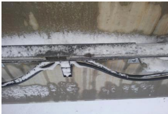
측면접촉식 전차선의 눈 내린 후 모습
