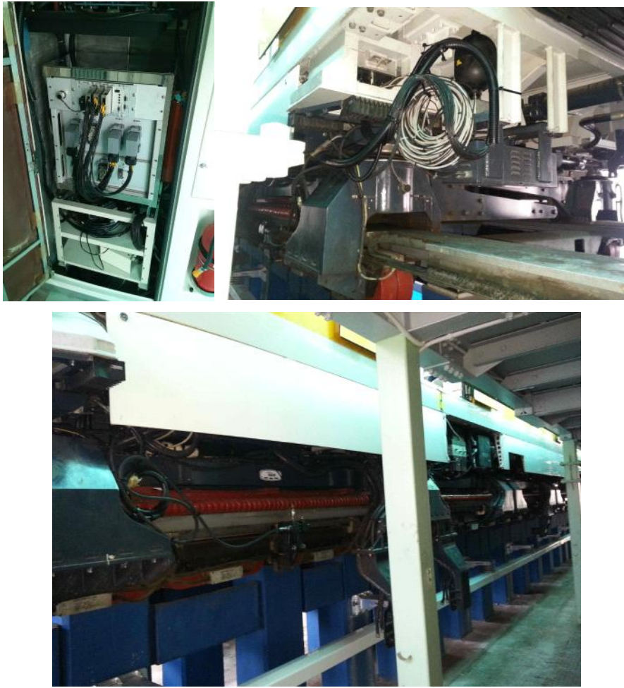
추가1량(MC2 CAR) 유압제동시스템 설치 상태
