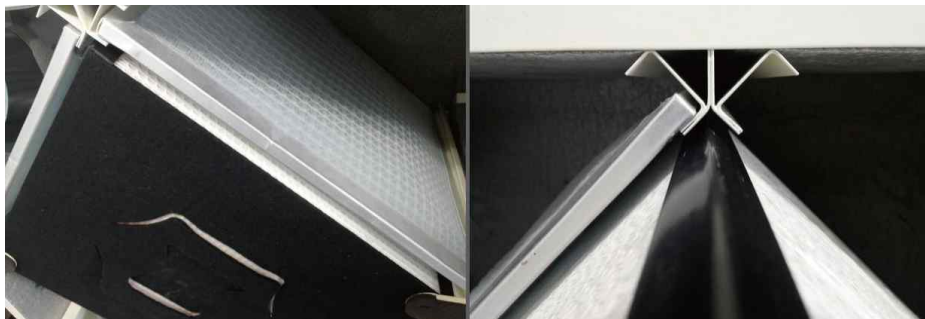
[그림 2] 기계식 환기장치 내부에 설치된 필터의 틈새
