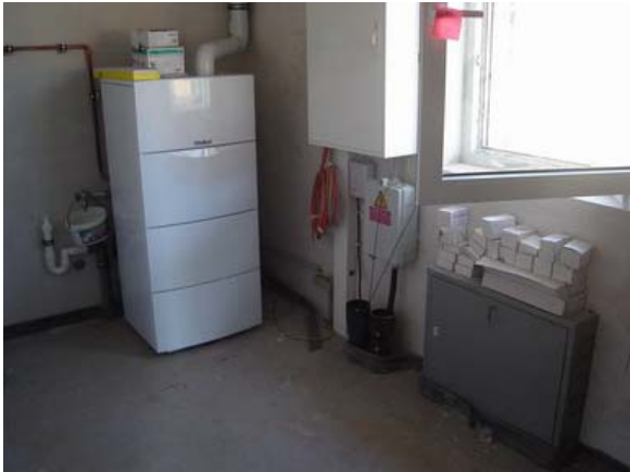
[그림 6.2.19] 기계실 가스 콘덴싱보일러와 분배기 설치
