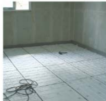
6 SI SYSTEM 시공완성
