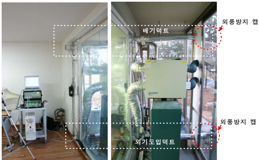
[그림 3.4.21] 외기도입덕트(하부) 및 배기덕트(상부)와 전열교환기 모습
