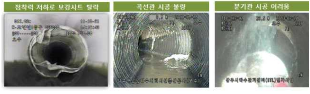
[그림 1-6] 기존 하수관 비굴착 부분 보수공법의 문제점
