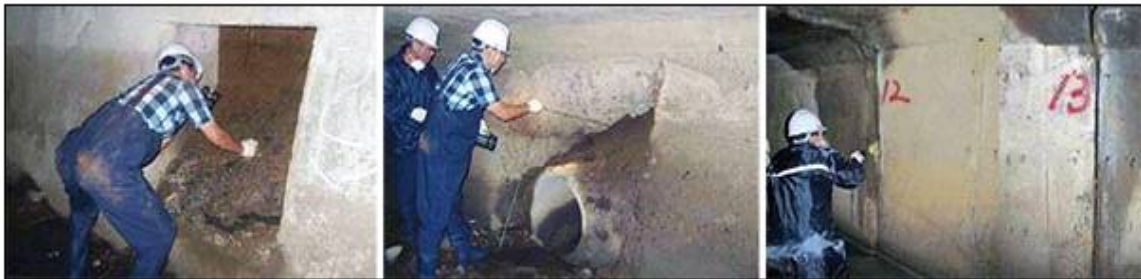
▲ 개구부 마감 불량 및 상수 동공 발생 / 연결관 불량 토사 유입 / 노후화에 의한 미음부 이격 및 누수
