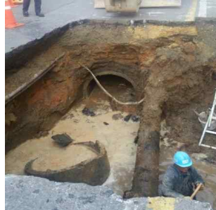
(b) 지중 관로 파손
