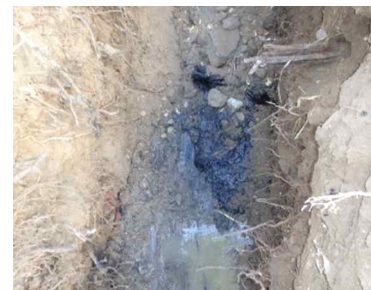
(c) 지중폐관 파손 및 토양오염
