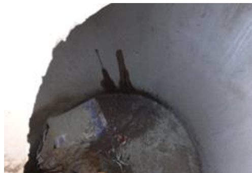
⑥ 고유동 충전재의 맨홀 내부(파손부) 유실 확인
