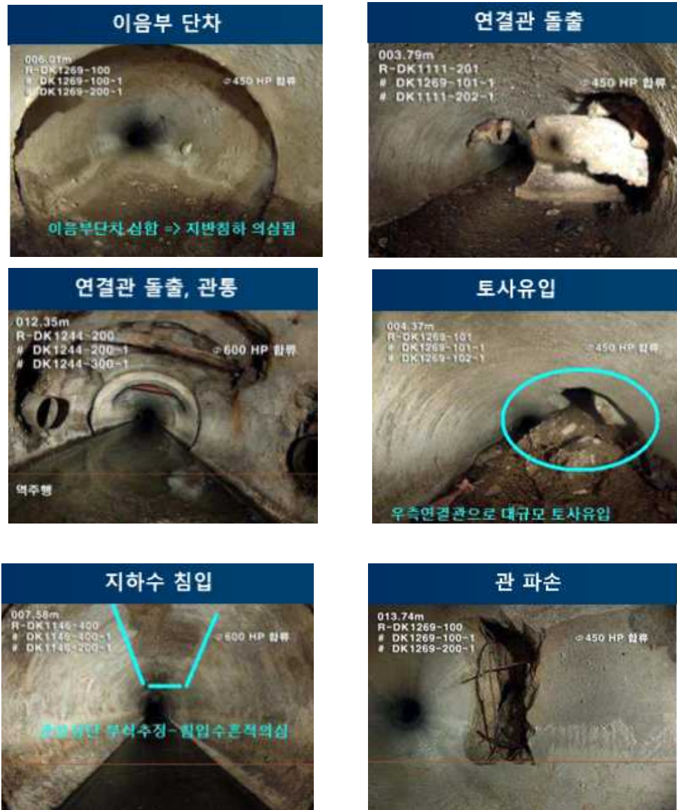
그림 42. 노후 폐관 내부의 다양한 결손 문제(고화질 cctv 차량 조사 결과)
