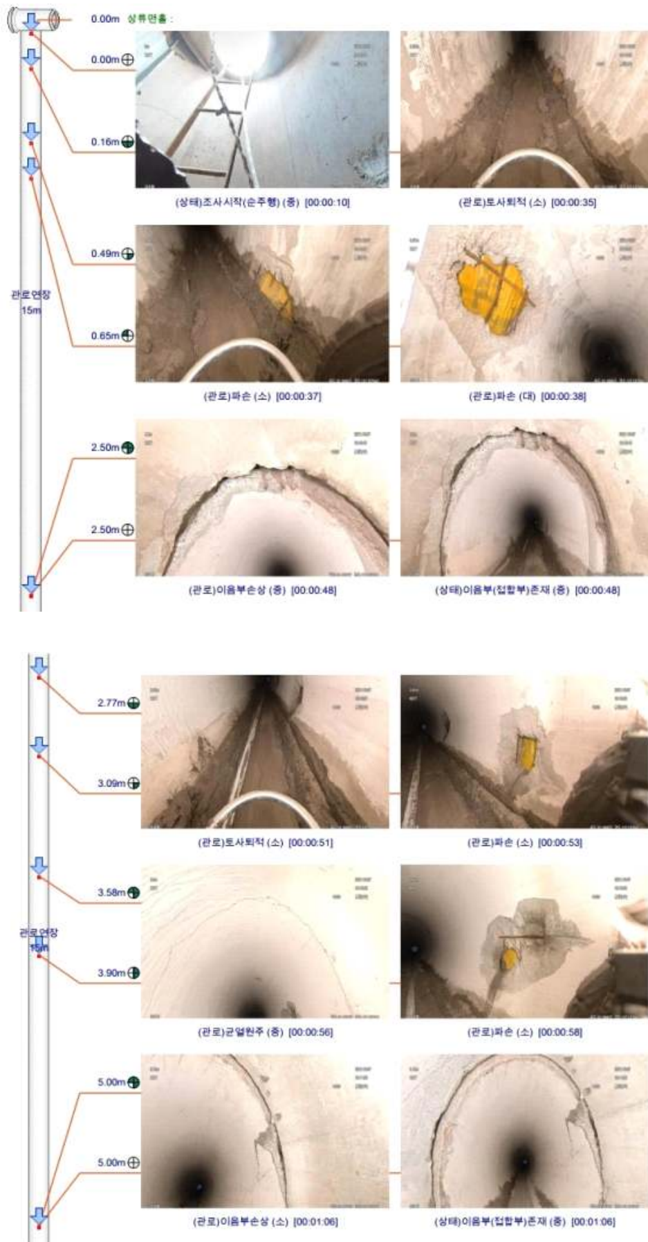
그림 51. CCTV 조사 결과
