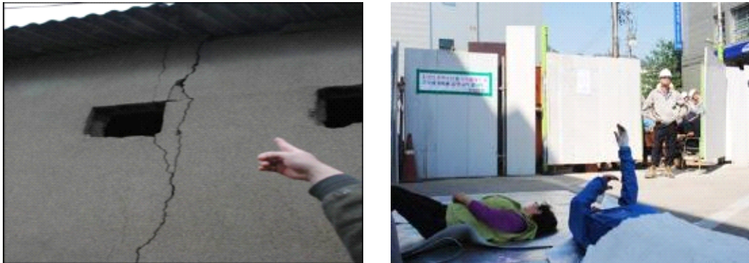
<그림 1.1.11> 터널 발파진동으로 인한 피해(좌측) 및 집단민원 사례(우측)
