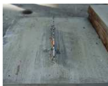
다. 콘크리트 표면의 파괴거동
