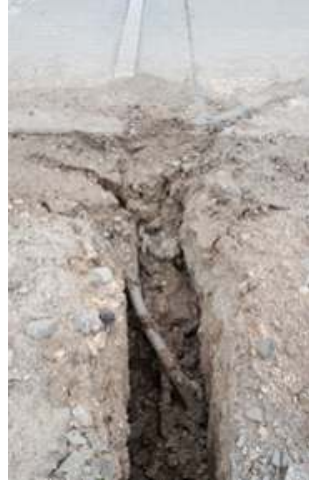
▲ 동결융해로 인한 파손
