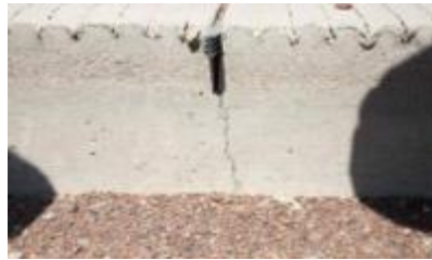
(ㄴ) 시공시 줄눈의 부재로 재시공
