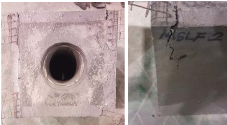
그림 5-5 스마트 콘크리트 정착구 상부 균열 형상
