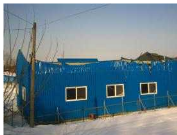
적설에 의한 컨테이너 지붕 파손
