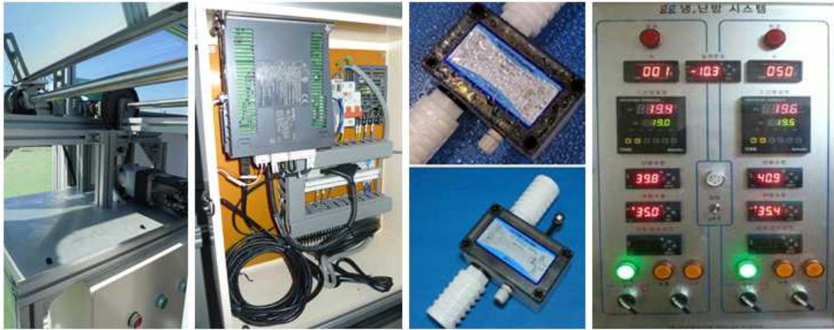
그림 A-2-5. 센서 및 구동 제어설비 (좌측부터: 광각패널, 패널제어기, 온습도센서, 냉난방제어기)
