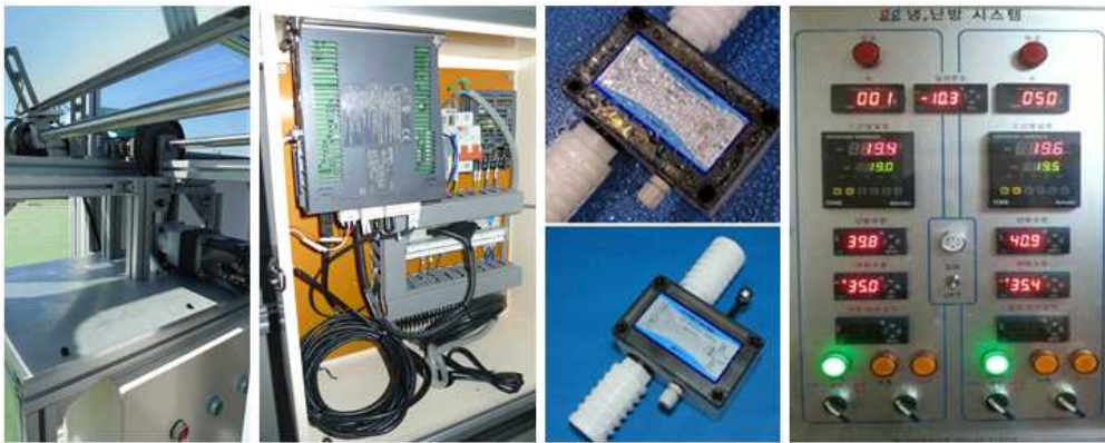
그림 3-4-29. 센서 및 구동 제어설비 (좌측부터: 광각패널, 패널제어기, 온습도센서, 냉난방제어기)
