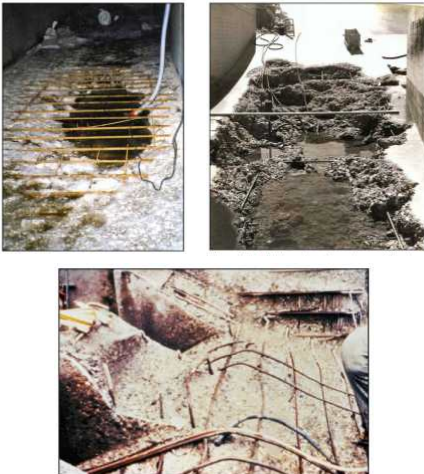
그림 1 하천횡단구조물 하류부 횡단구조물 파괴사례
