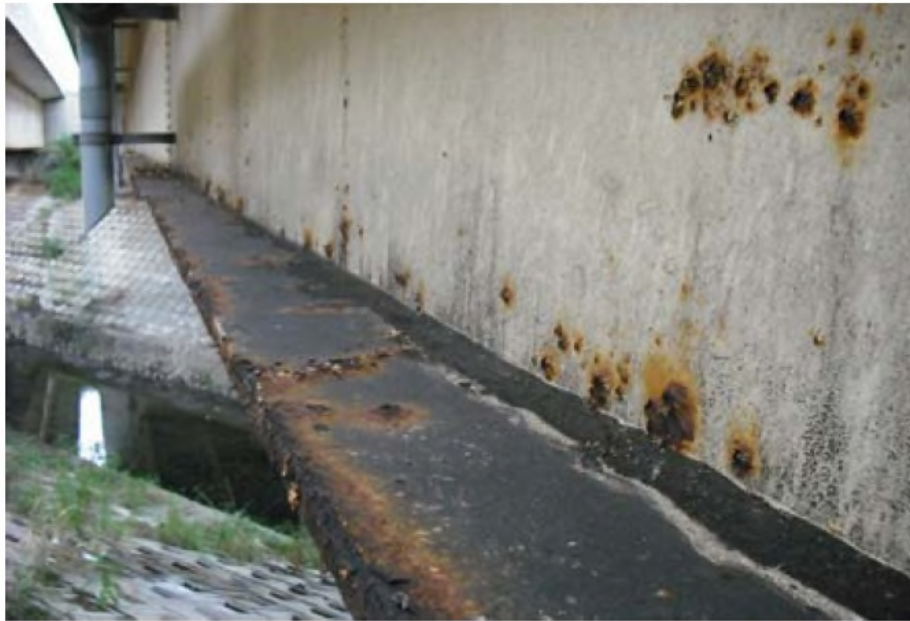
下フランジ損傷状況
