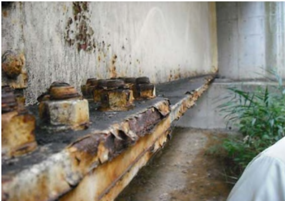
ボルト接合部腐食状況
